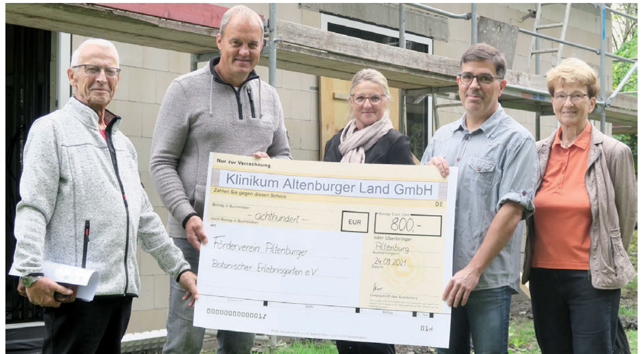
Zur Scheckübergabe auf der Baustelle trafen sich vor Ort: v.l. Dr. Wolfgang Preuß, Michael Wolf, Christine Helbig, Jörg Kipping, Elke Seiferth
