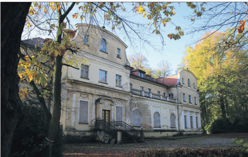
Foto links: Blick auf Schloss Tannenfeld. Foto rechts: Trin Mihng (l.) und Tino Meinel von der Firma Bittner Erdabbruch aus Kretzschau in Sachsen-Anhalt beginnen mit der Entkernung des Wirtschaftsgebäudes.
