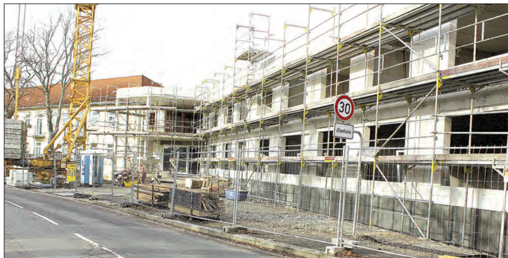
In nur sechs Monaten entstand der Rohbau in der Bebelstraße, der mit dem bestehenden Gebäude verbunden ist
