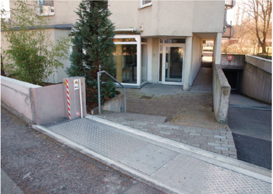
Abb. 95: Automatisches Schutztor einer tiefliegenden Garage und eines Eingangs
