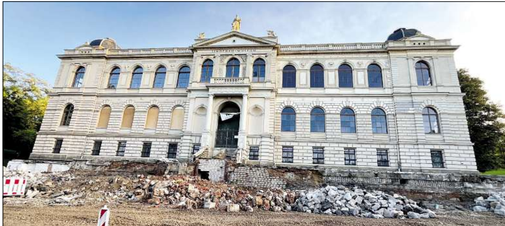
Die Terrasse wurde abgerissen. Hier soll dann das neue Stadtgeschoss angesetzt werden.
