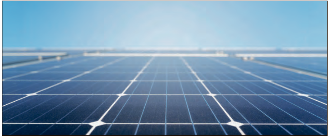
Solarmodule einer Photovoltaikanlage.
