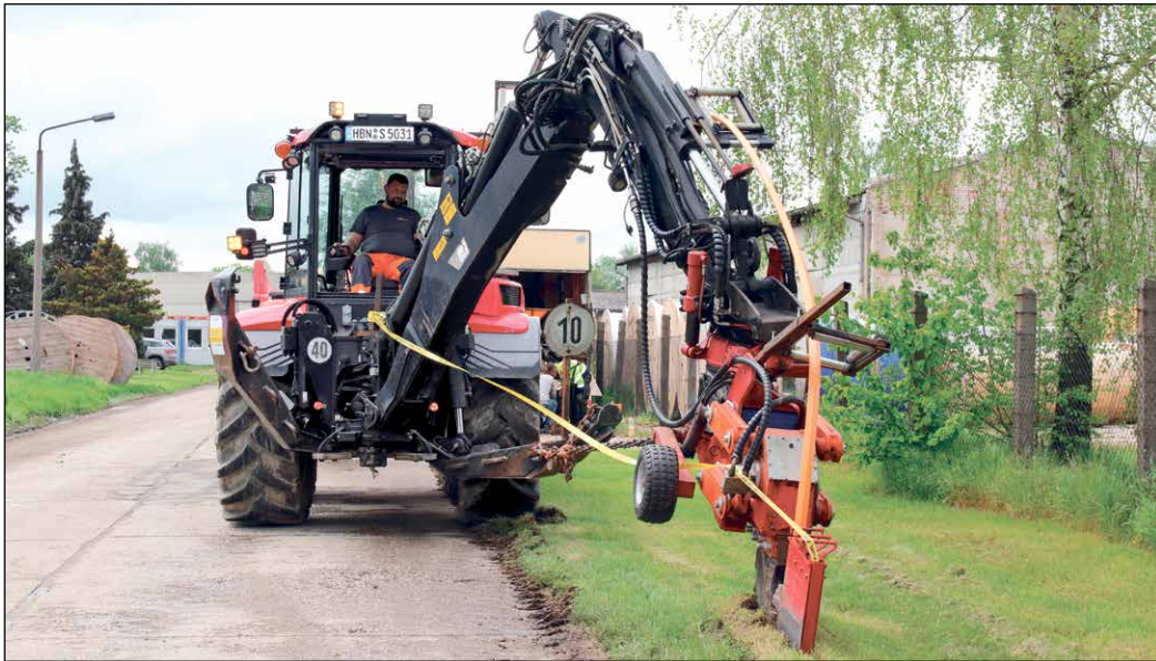
Im Pflügeverfahren (hier Baustelle bei Altkirchen) können mehrere Kilometer Glasfaser-Leitungen am Tag verlegt werden.
